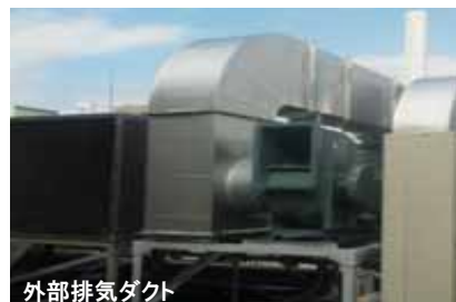
外部排気ダクト
