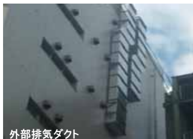
外部排気ダクト
